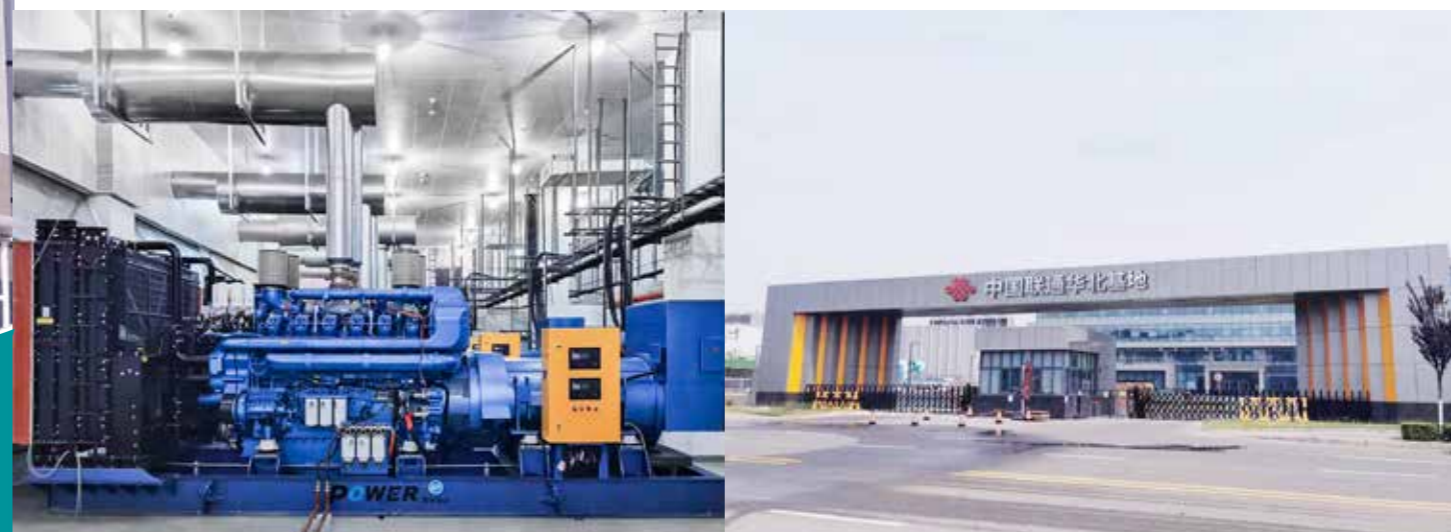
△中国联通华北基地机组 China Unicom North China Base
