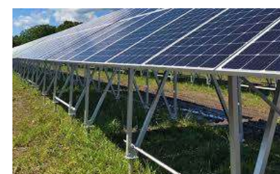
太陽光パネルの枠 (Solar panel frames)
