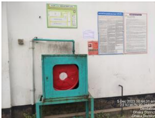
Fire hose reel.jpg
